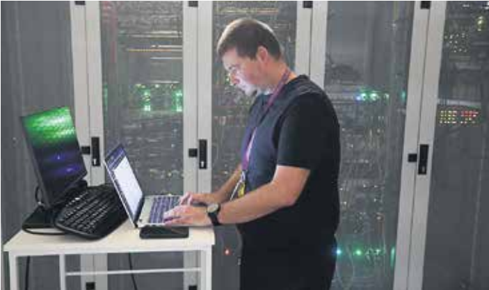
SWAN – dátové centrum Bratislava
