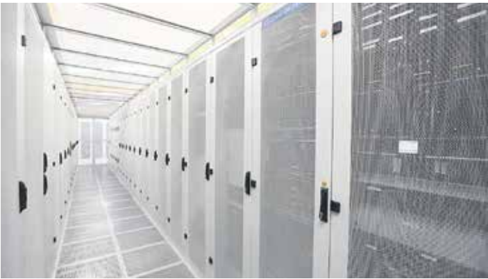
SWAN – dátové centrum Bratislava
